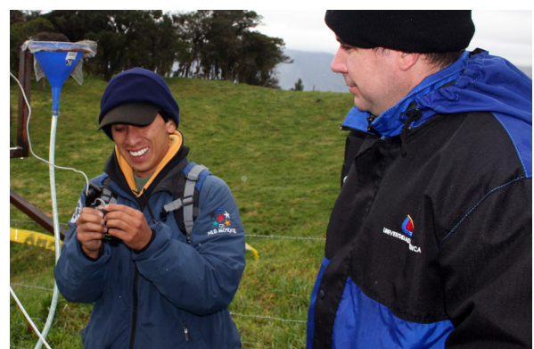
INSTALACIÓN DE PLUVIÓMETROS POR EL PERSONAL TÉCNICO DE PROMAS (2010)
